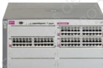
Hp ProCurve Switch 5372XL (J4848A) 72 ports 10/100Tx installés et 5 logements disponibles pour modules
